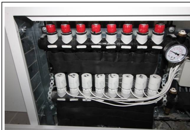
523/31/A/10 hrsz-ú lakás, padlófűtés osztó gyűjtő
