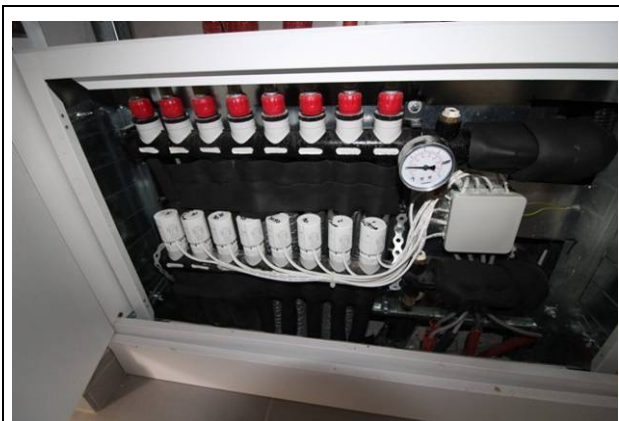
523/31/A/9 hrsz-ú lakás, padlófűtés osztó gyűjtő
