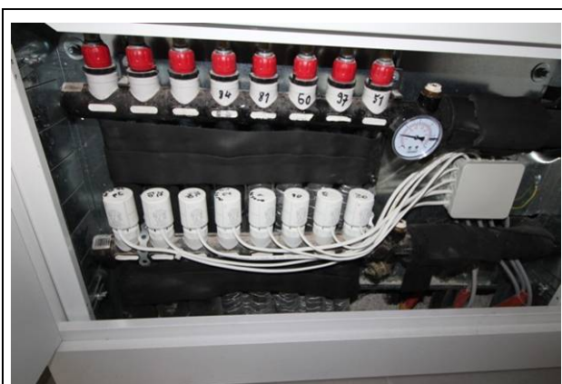
523/31/A/6 hrsz-ú lakás, padlófűtés osztó gyűjtő
