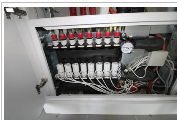
523/31/A/11 hrsz-ú lakás, padlófűtés osztó gyűjtő
