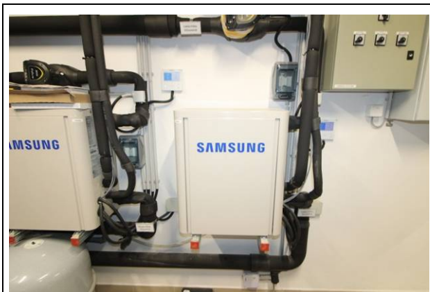
alagsori gépészeti helyiség, hőszivattyú (lakásokhoz tartozó)
