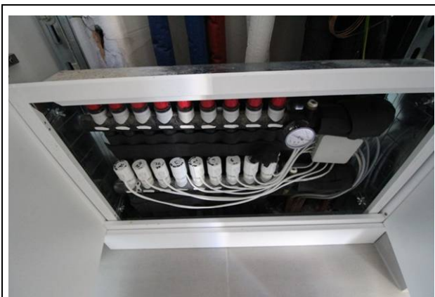
523/31/A/8 hrsz-ú lakás, padlófűtés osztó gyűjtő
