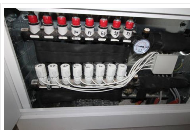
523/31/A/6 hrsz-ú lakás, padlófűtés osztó gyűjtő
