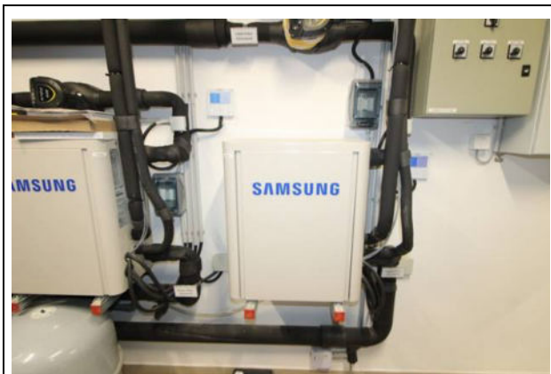
alagsori gépészeti helyiség, hőszivattyú (lakásokhoz tartozó)
