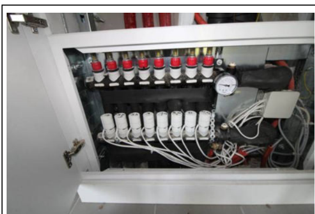
523/31/A/11 hrsz-ú lakás, padlófűtés osztó gyűjtő
