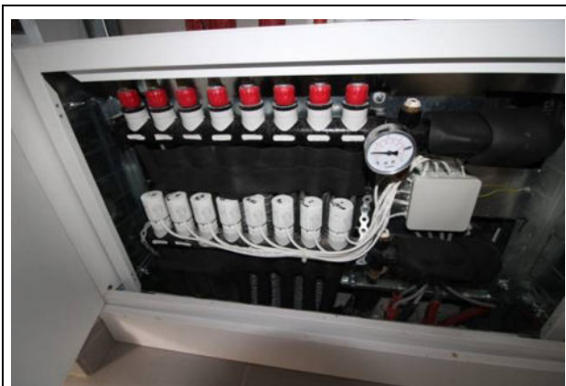
523/31/A/9 hrsz-ú lakás, padlófűtés osztó gyűjtő
