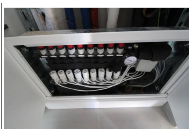
523/31/A/8 hrsz-ú lakás, padlófűtés osztó gyűjtő
