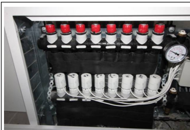
523/31/A/10 hrsz-ú lakás, padlófűtés osztó gyűjtő
