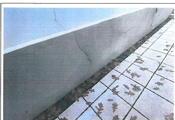
repedés és vizesedés nyomok a homlokzaton
