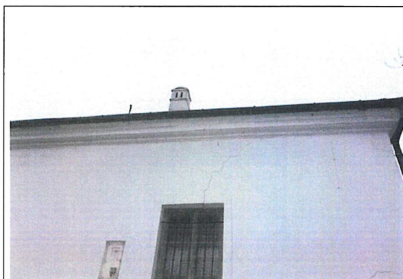
repedés a homlokzaton
