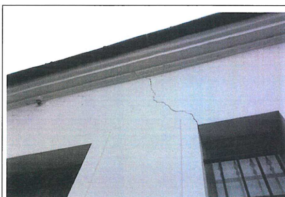
repedés a homlokzaton
