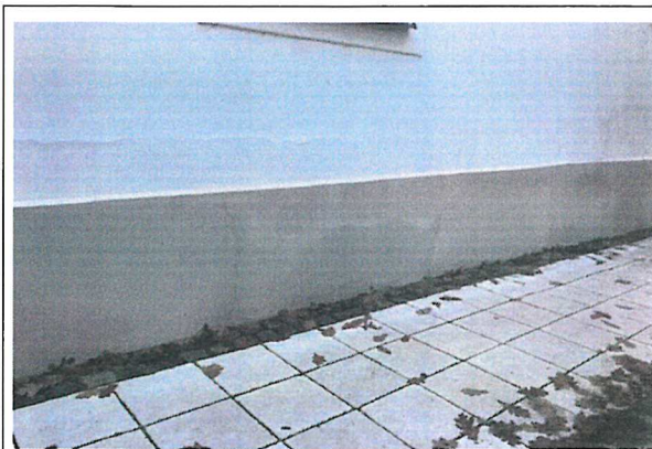
vizesedés nyomok a homlokzaton
