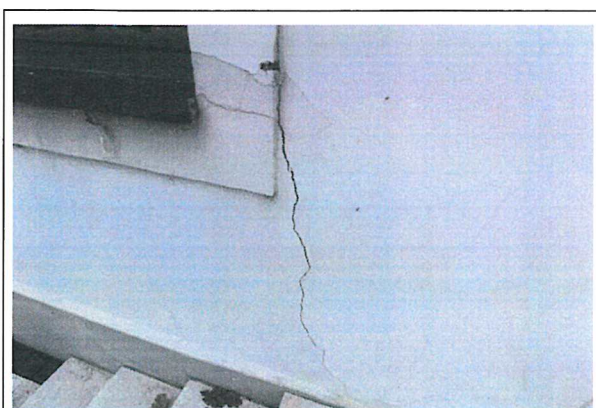
repedés a homlokzaton
