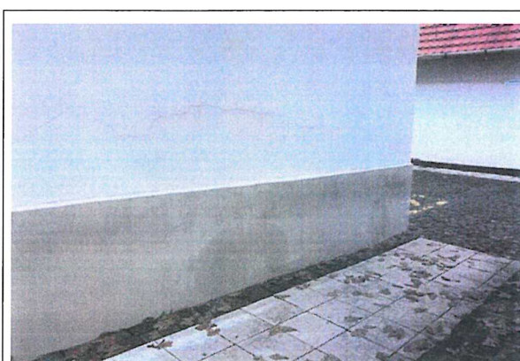
vizesedés nyomok a homlokzaton
