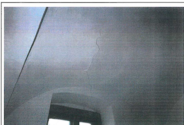
repedés a mennyezeten
