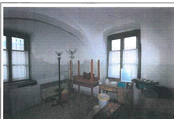
iroda, vizesedés a falon, repedés a mennyezeten
